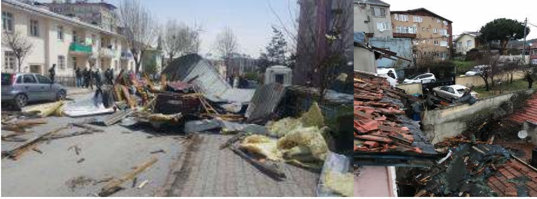
Şekil 3. (a) Sivas'ta rüzgardan uçan çatılar [5] İstanbul'da rüzgardan uçan çatılar [6]
