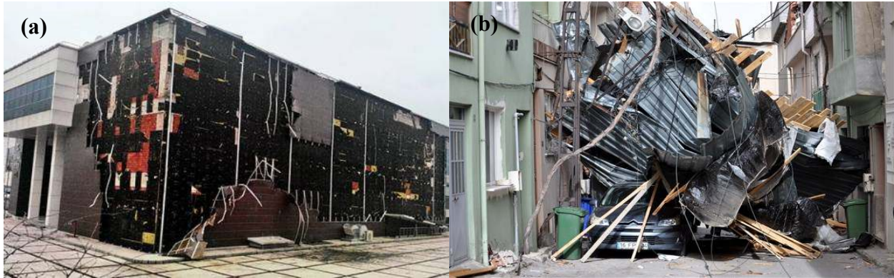
Şekil 1. Bursa’da lodos sonrası (a) Afet Eğitim Merkezi Binasının görünümü [1] (b) bir sokak görünümü [2]
